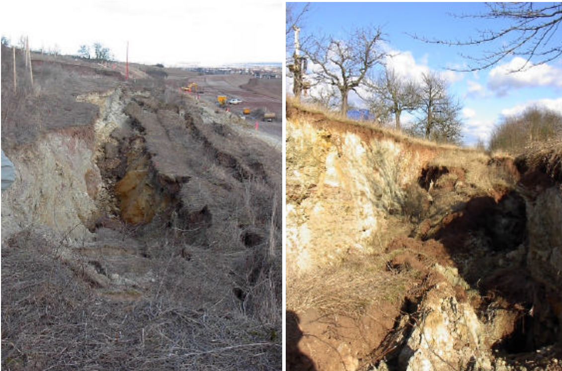
Bild 3 (links): Bereich der ehemaligen Böschungsschulter Bild 4 (rechts): Hintere Abrisskante des Rutschkörpers, ca. 40 bis 45 m hinter der ehemaligen Böschungsschulter
