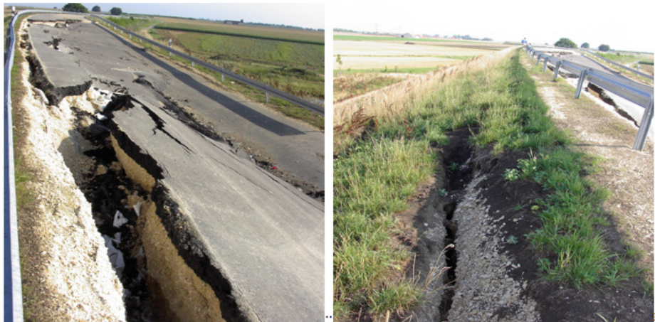
Abbildung 2: Schadensbild beim 2. Geländbruch
